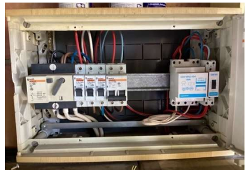
(Elektrisch bord - binnenkant)
